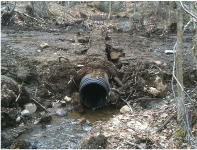
Fig. 22 – Exemple d'un ponceau mal installé (radié trop haut, aucune stabilisation ni géotextile)
